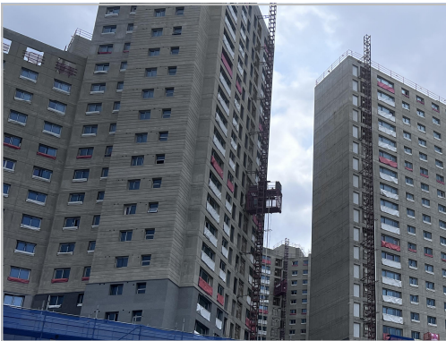
건설용리프트: 건설자재 등을 운반하기 위해 레일을 따라 상하로 움직이는 설비 장치
