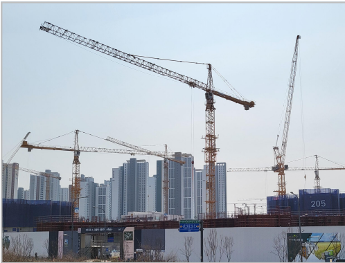
T타워크레인: 탑 위에 선회하는 기계대를 싣고 고층 건축에 사용되는 기중기
