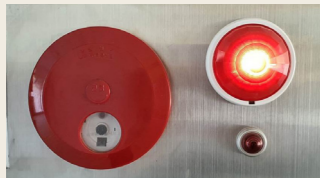
P형 발신기와 표시등
