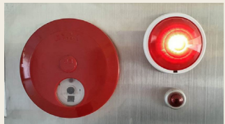
P형 발신기와 표시등
