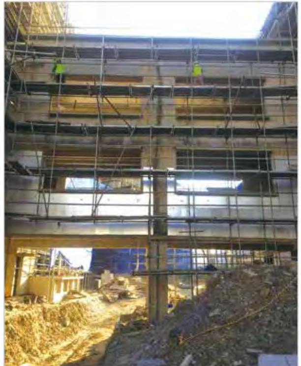
연결복도를 후시공하는 경우가 많은데 이 현장에서는 선시공을 하고 하부를 굴착하여 장비의 통로를 확보하여 작업한것이 특징
