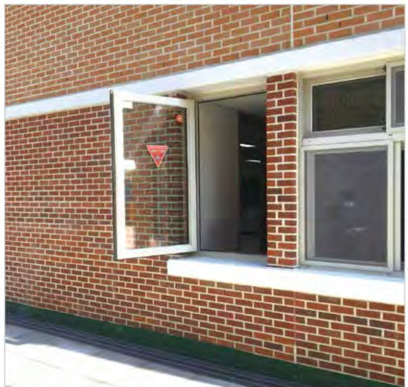
소방관 출입창 2층 연결 데크에 면하여 설치된 소방관 진입창은 외부에서 열수 있는 장치로 보안에 취약하다.
