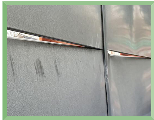
참고2-1. 가설방음판넬 접합상태 확인 시 (판넬 연결 상태 불량)
