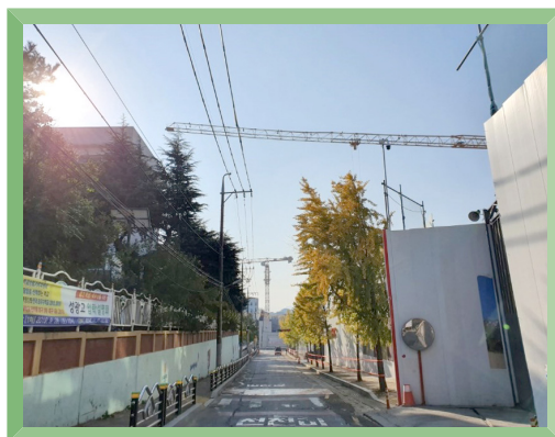
참고6. 타워크레인 학교부지 침범
