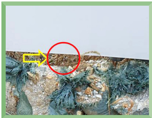
참고2-2. 가설방음판넬 접합상태 확인 시 (바닥 차폐 상태 불량)
